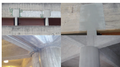
由於2016年中義大利地震，一些柱子使用纖維複合材料來增強結構強度。
